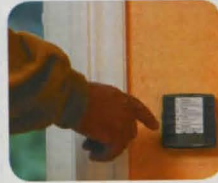
Centralstyrning av belysning...
