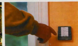
Centralstyrning av belysning...
