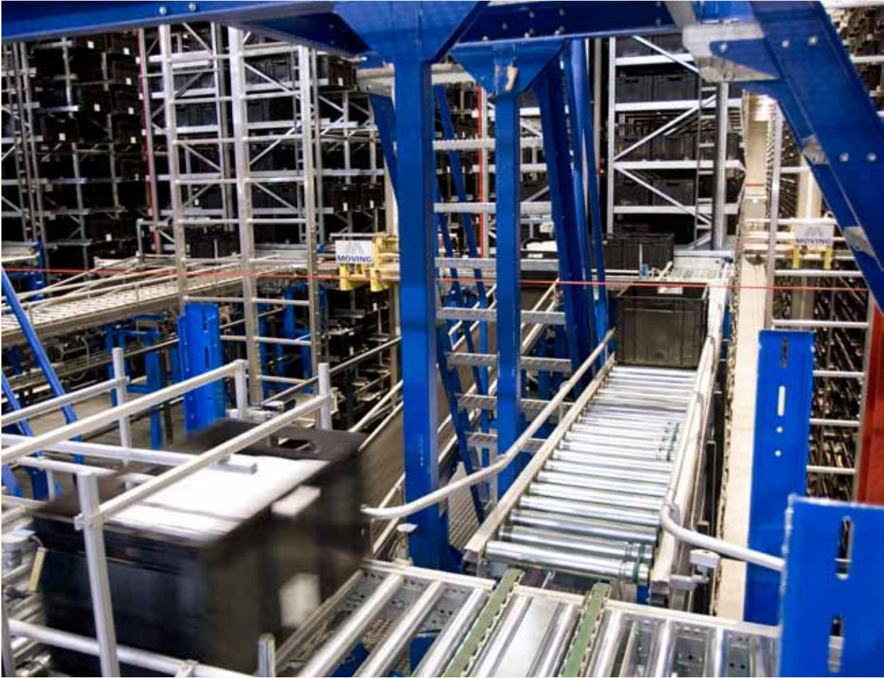
Clas Ohlsons distributionscentral i Insjön lagrar, sorterar och distribuerar varor till både butiker och distanshandel på våra fyra marknader.
